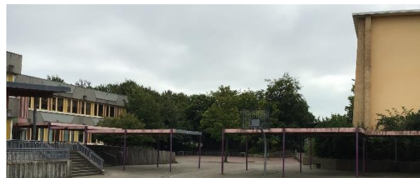
Unser Wunsch: Schneller Abbau der maroden Überdachung und ein Erweiterungsbau, der die beiden Häuser der „Paula“ verbindet.
